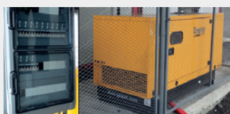
Alimentation en énergies
